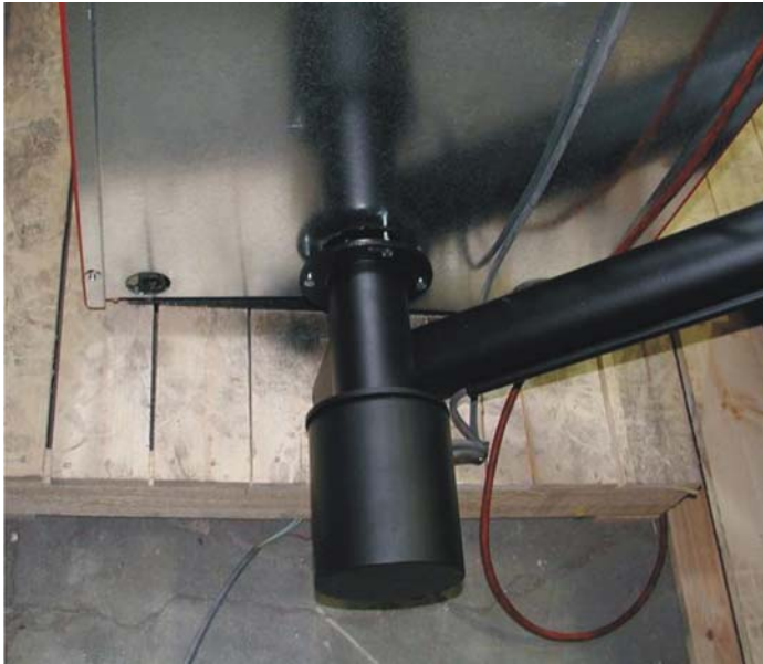
Figur 10 Automatisk askutmatning motor
